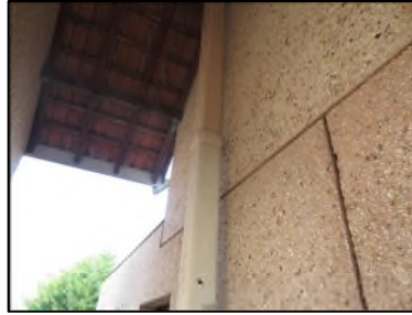
Photo N° 588 AMIANTE CIMENT -- PALIER VOLEE ESCALIER +3 Gaines & coffres verticaux Ventilation haute (Fibres-ciment)
